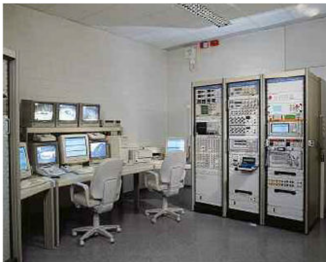
Slika 12.3: Tipičan izgled izolovane ( shielded ) kontrolne sobe sa mernom opremom.
